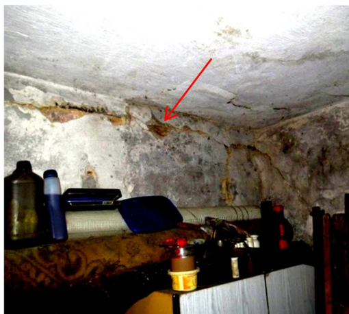
Rys. 4. Poziome ścięcie muru poniżej stropu nad piwnicą
