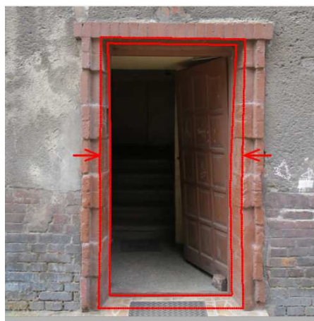
Rys. 3. Deformacja otworu drzwiowego w ścianie zewnętrznej
