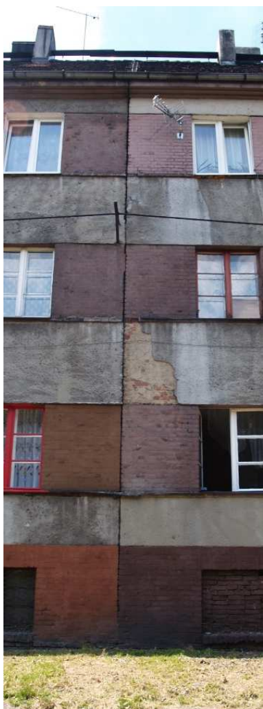
Rys. 2. Przykład częściowo zaciśniętej szczeliny dylatacyjnej
